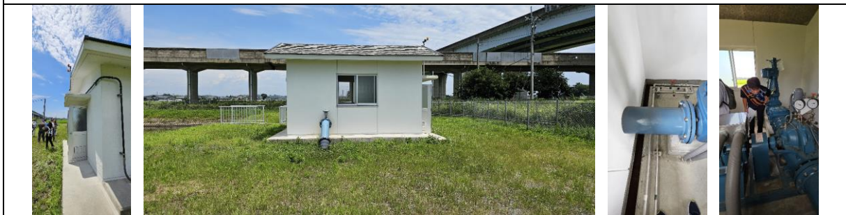
揚水機場內部抽水機以鑄鐵管供水
