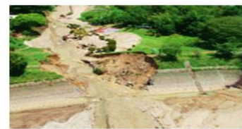
2022年8月豪雨造成蓄水池決堤 （山形縣川西町）
