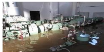
抽水機站淹水（2019年19號颱風） （宮城縣角田市）
