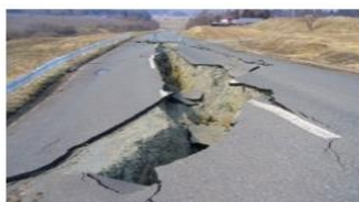
破損的農道（311大地震） （岩手縣奧州市）
