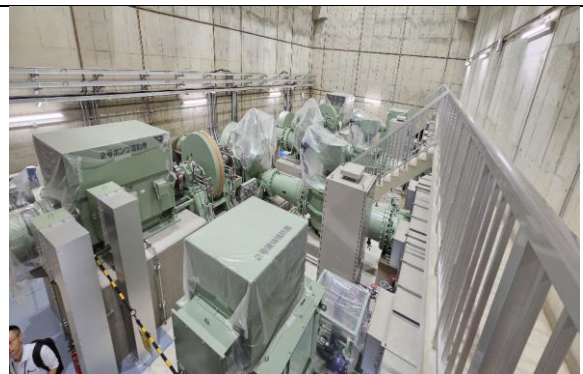
新設抽水機組
