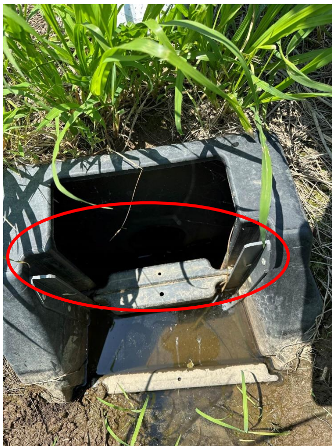
圖為千波湖土地改良區中的簡易水閘
