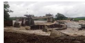
總水門損壞 （北海道北見市）
