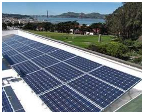
圖 38 金門國家遊憩區總部辦公室屋頂裝設太陽能電板
