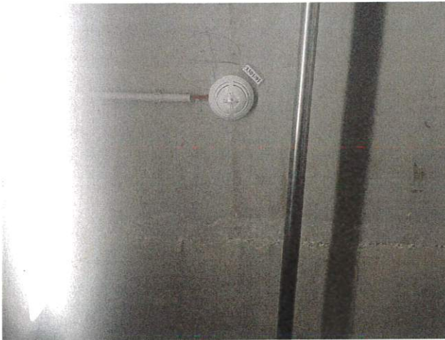
圖 12 火警探測器標示
