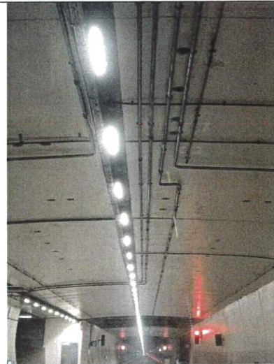
圖 5 阿爾貝格隧道細水霧設施
