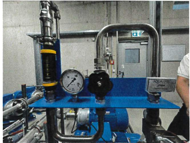
圖 17 加壓馬達泵浦設備-2
