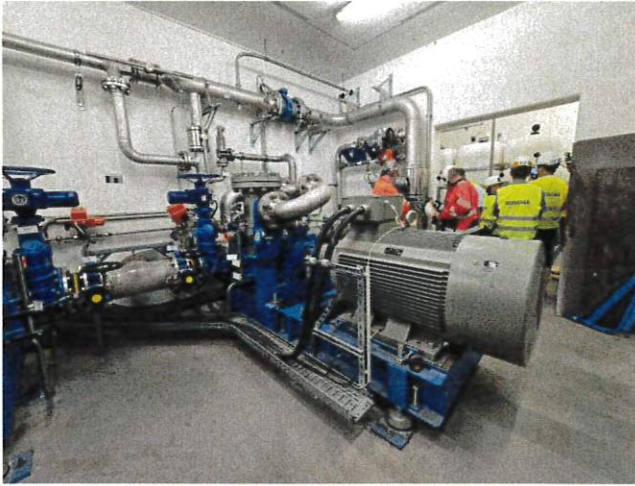
圖 8 檢視阿爾貝格隧道細水霧設施泵浦設備
