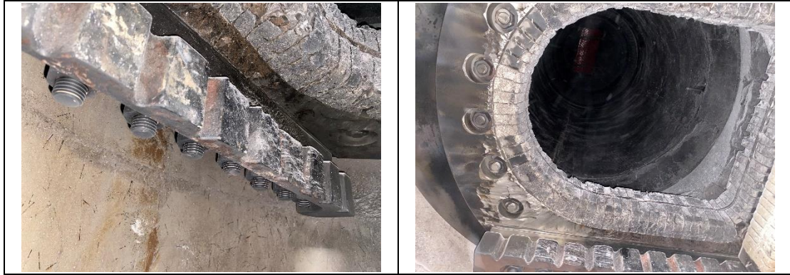
圖 2 SCSV(LV-1003)左右兩邊 GUIDES 沖蝕受損
