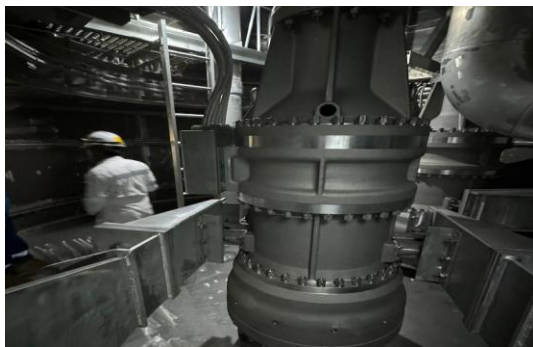
底部 Cargo pump(船方提供)
