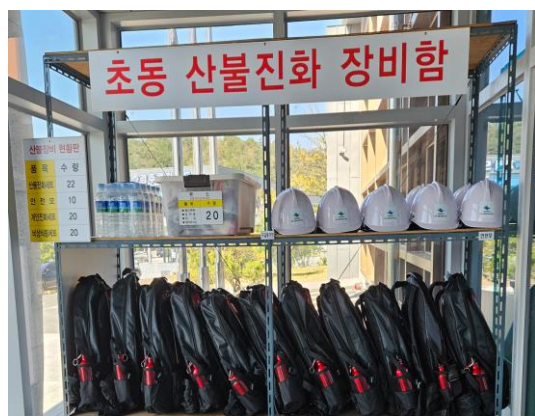
圖 38 初期滅火設備
