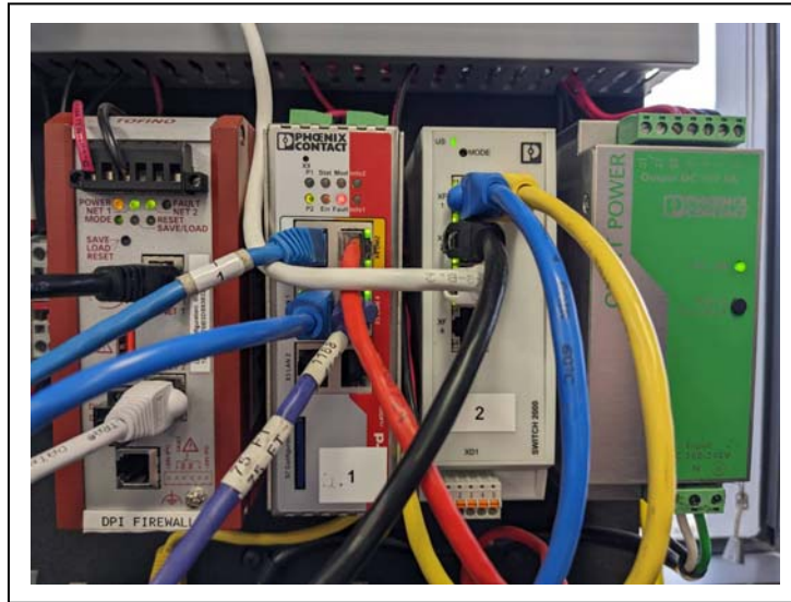
網路設備(左起:防火牆、防火牆 DMZ、switch、power supplier)
