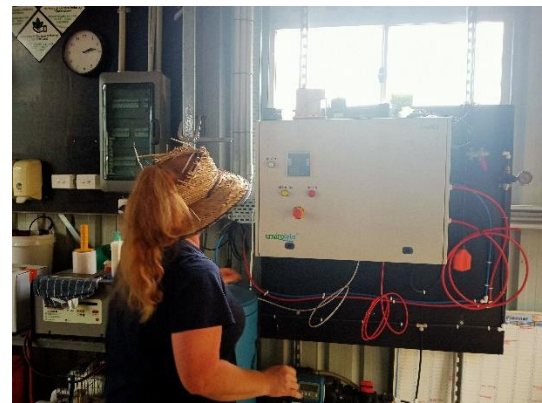
圖47.苗圃配電及自動控制系統
