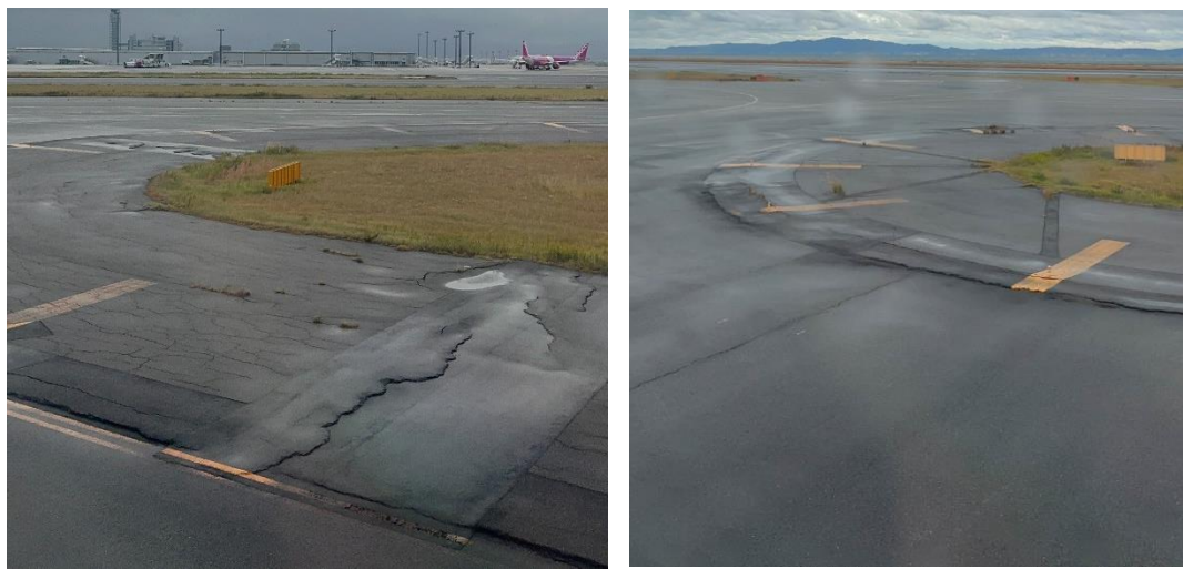
圖 2.10 滑行道面損壞情形
