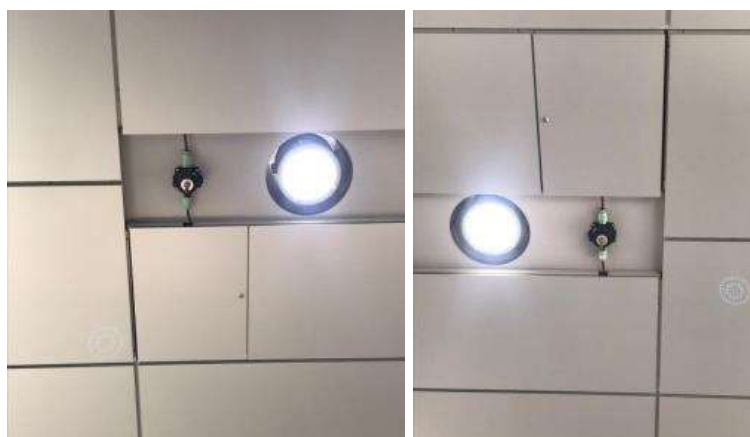
圖 26 拍攝天花板裝置氫氣感測器 2 具 (現場共 5 具)
