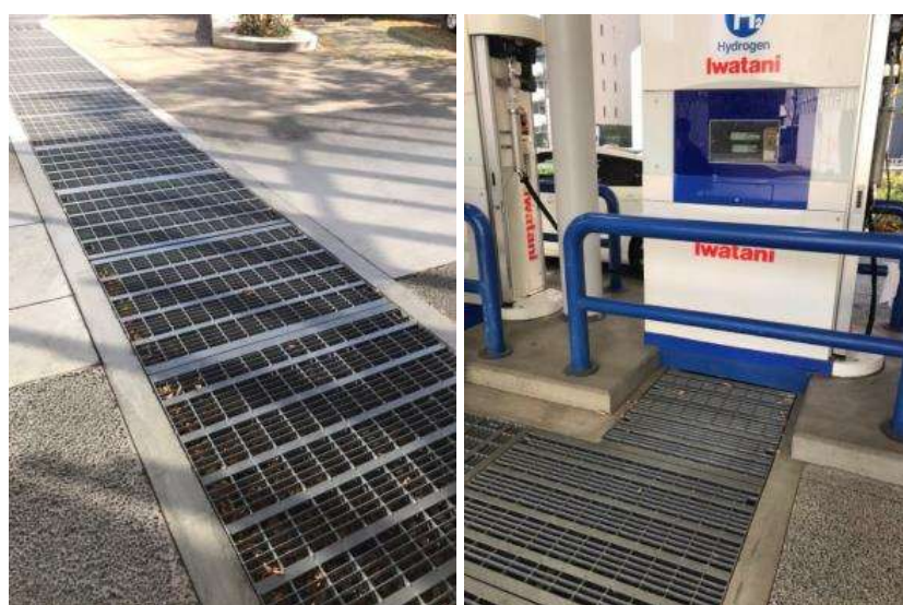
圖 24 地下氫氣管路
