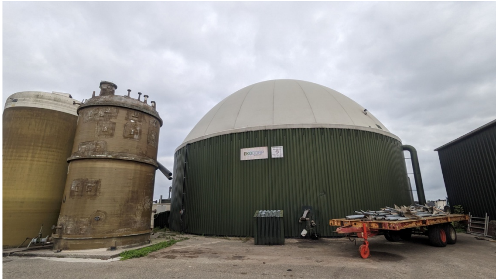
圖 21. Ekodorp 牧場的沼氣生產設備
