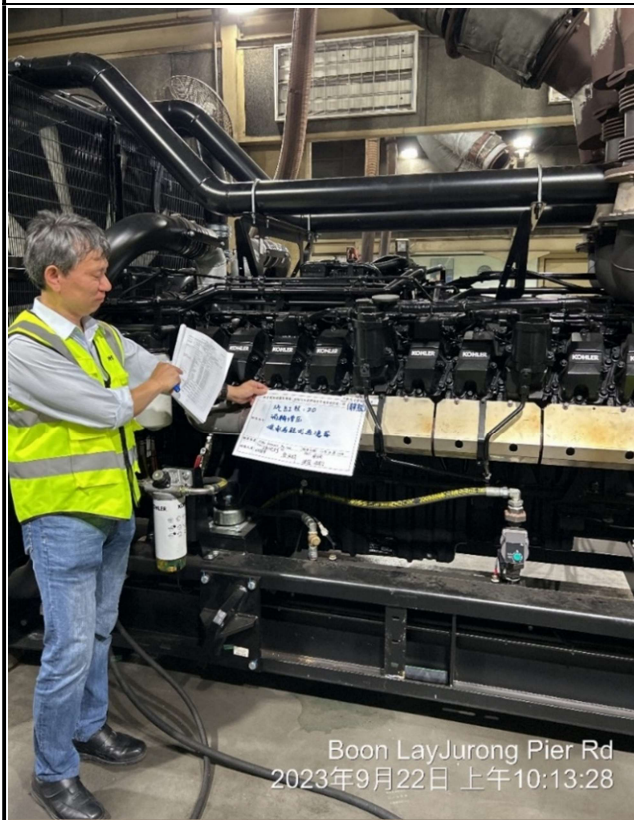
柴油引擎發電機組汽缸數檢查
