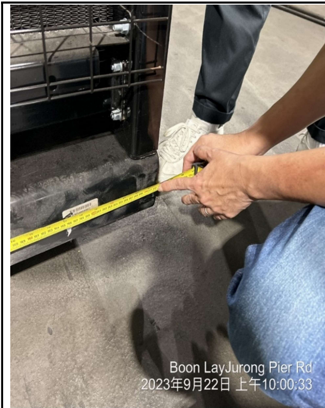
柴油引擎發電機組尺寸檢查(一)
