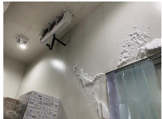
圖27、壓縮機冷排部分有結霜情形
