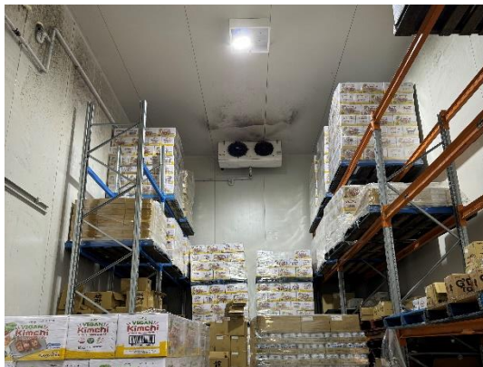
圖28、冷凍庫內結霜易影響製冷效率
