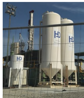
圖 38、立式泥漿儲罐（水化搬土泥漿）
