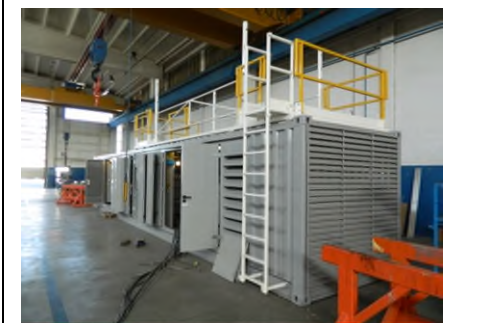
圖 28、HPU 系統廠驗及訓練
