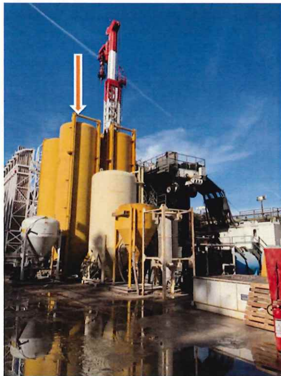
圖 26、套管水泥儲罐(箭頭處)
