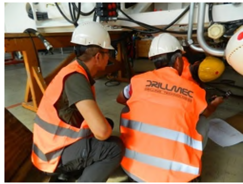
圖 15、以設計圖對照實際現場設備，進行液壓元件 Pulldown Block 廠驗。
