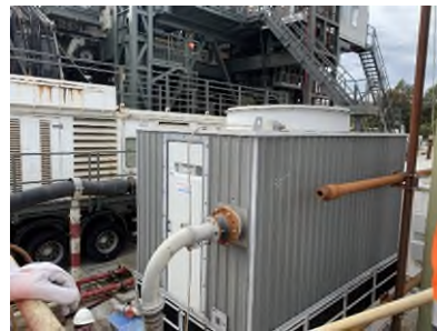
圖 41、泥漿冷卻系統的冷卻塔，外型似大型空調。
