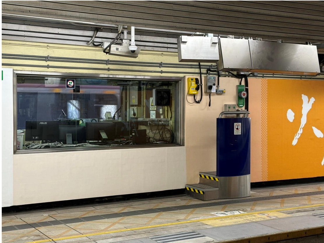
圖表 20. 東鐵線月台控制室
