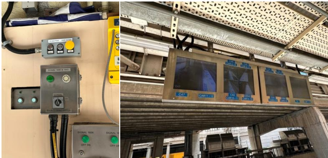
圖表 21. 東鐵線月台營運人員操作按鈕及 CCTV 設置
