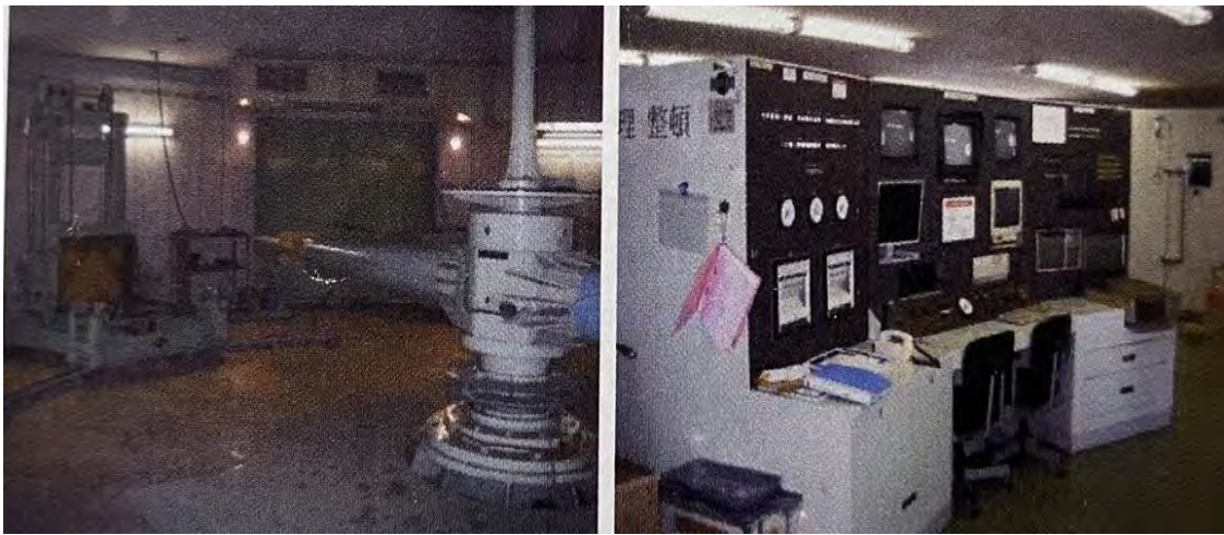
圖 45 高速旋轉設備及控制室
