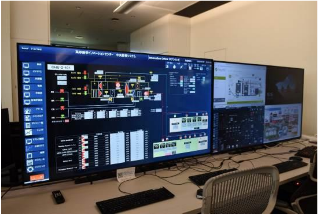
圖 119 高砂熱學創新中心辦公棟能源管理系統控制後台
