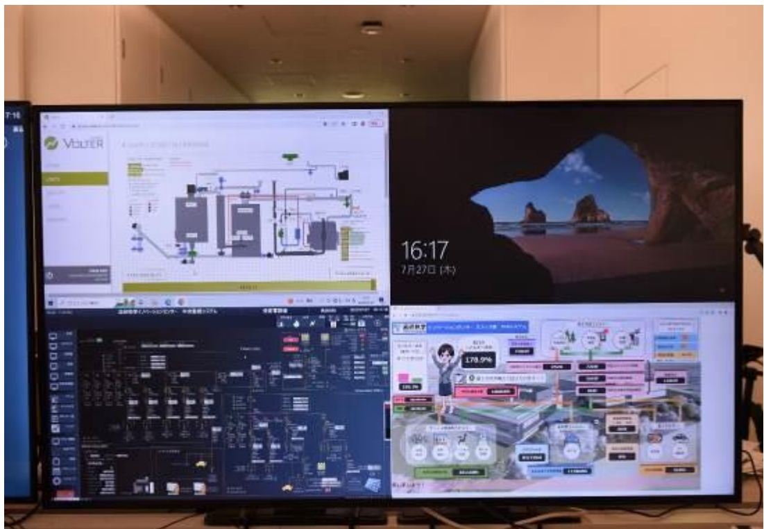
圖 118 高砂熱學創新中心辦公棟能源管理系統與 ZEB 系統展示控制後台
