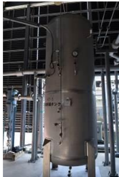
圖 127 水電解之氫燃料儲槽
