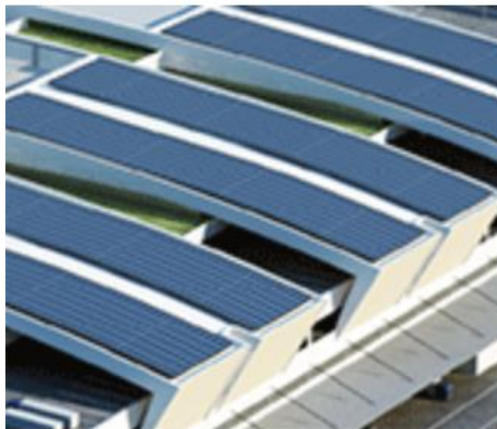
屋頂太陽電池板
