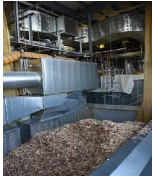
圖 124 生質能發電用木屑進料槽
