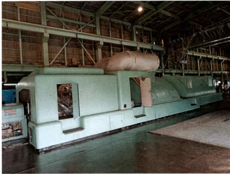
圖二 Cabras#2 汽輪發電機
