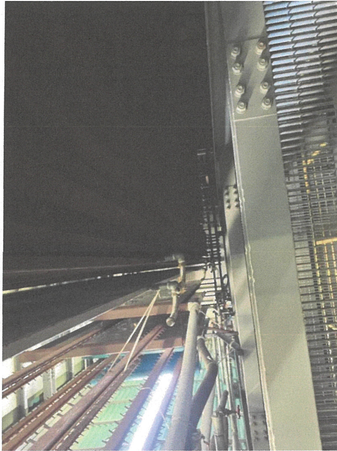
圖(十二)ESP 測試塔內集塵板
