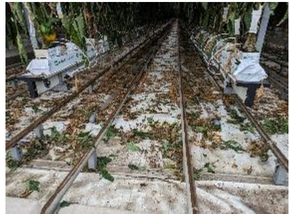
溫室使用之加溫管及軌道
