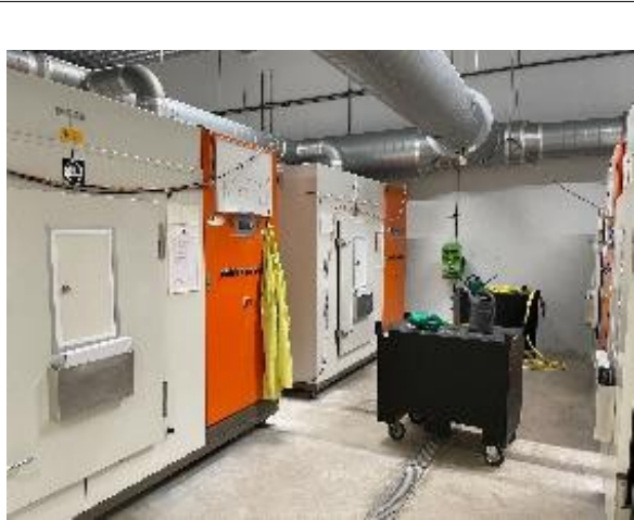
WUR 生長箱設備
