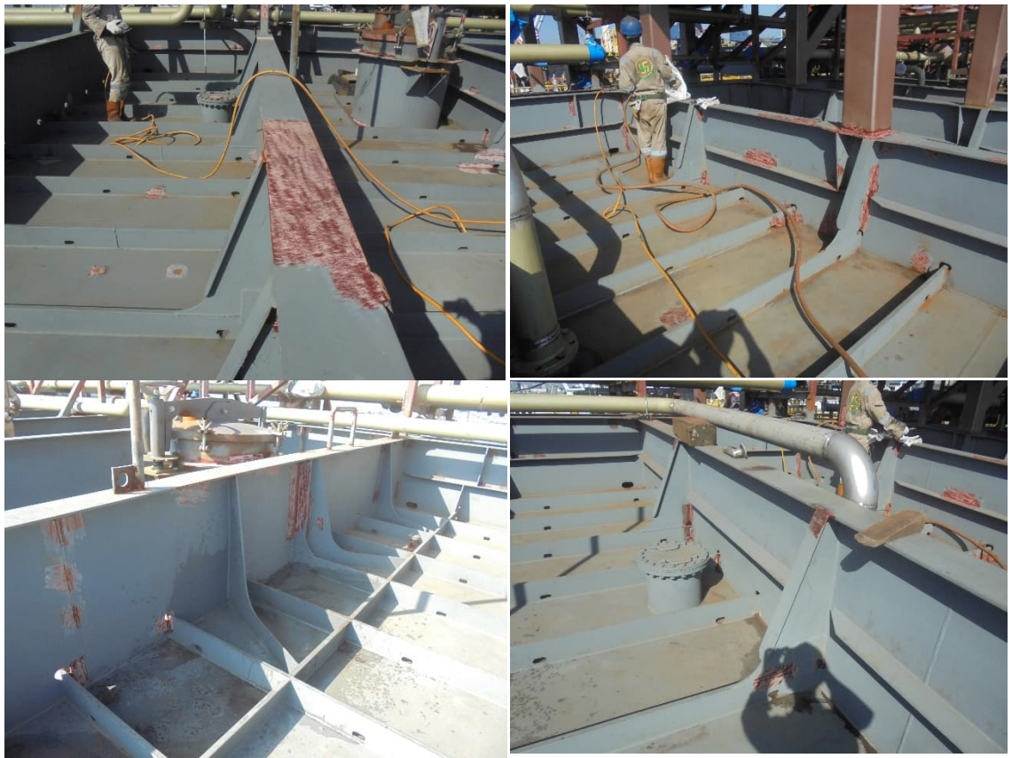
甲板及結構補漆及研磨之狀況，已要求暫停此部分之施工
