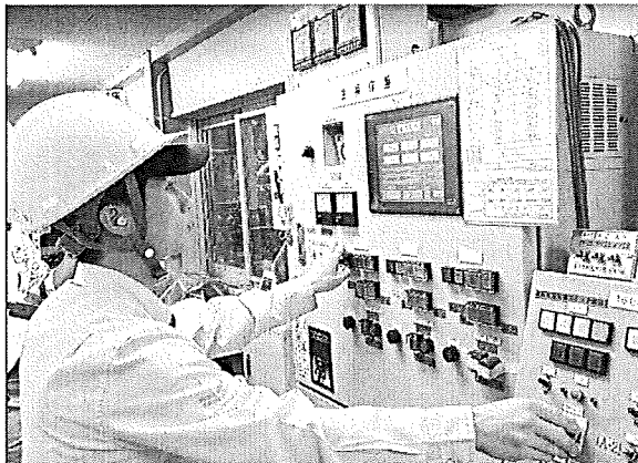
發電機負荷測試
