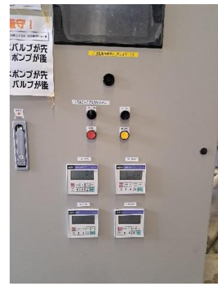
圖2-56 佐渡深層海水電透析設備監測器
