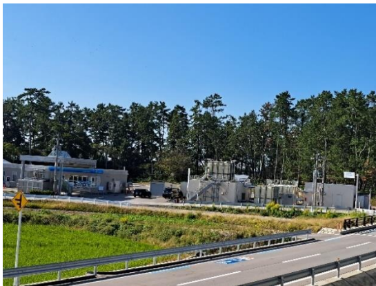
圖2-2 入善深層海水分水設施全景
