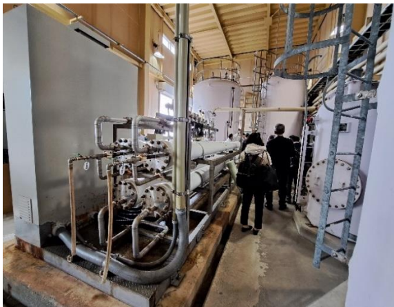
圖2-57 佐渡深層水製水桶槽
