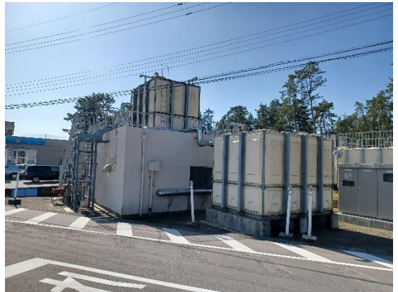
圖2-3 入善深層海水儲水槽
