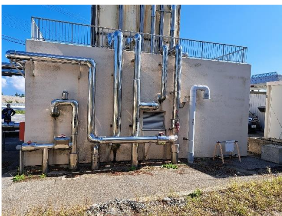
圖2-4 入善深層海水分水設施外部管線
