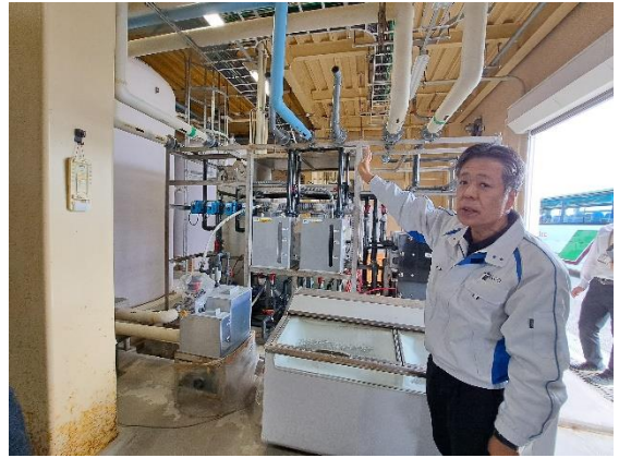
圖2-54 佐渡深層海水電透析設備說明
