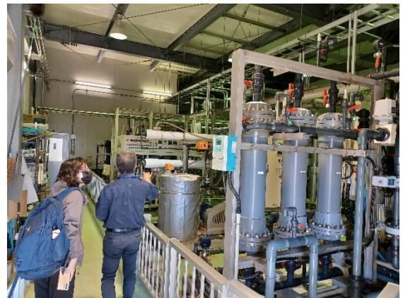
圖2-79 駿河灣深層水分水設備
