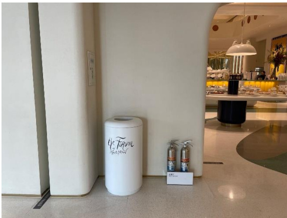
圖 197 銀白的滅火器與空間搭配較為不突兀。
