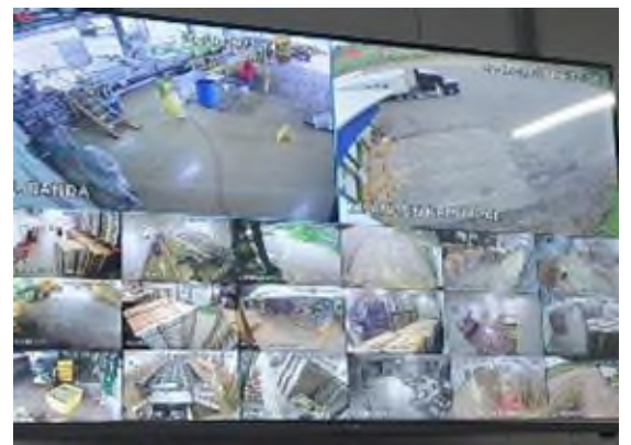
圖20、包裝場全區採數位化監控系統
