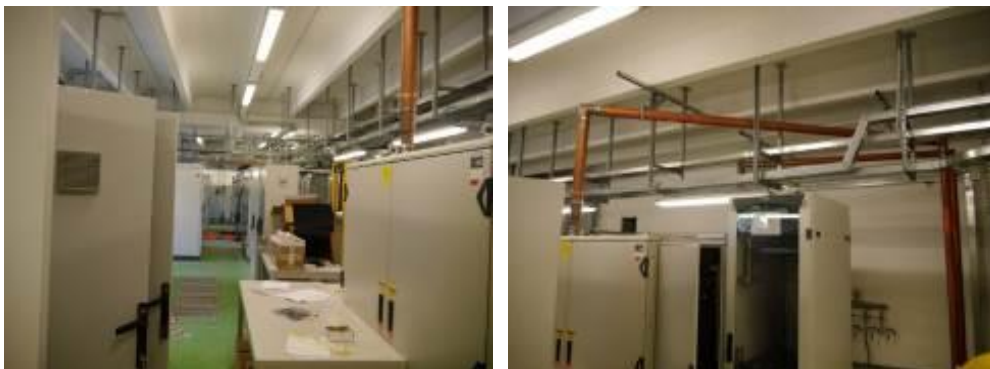
圖八十九、參觀電氣設備室：RF 控制箱及 RF 傳送管路
