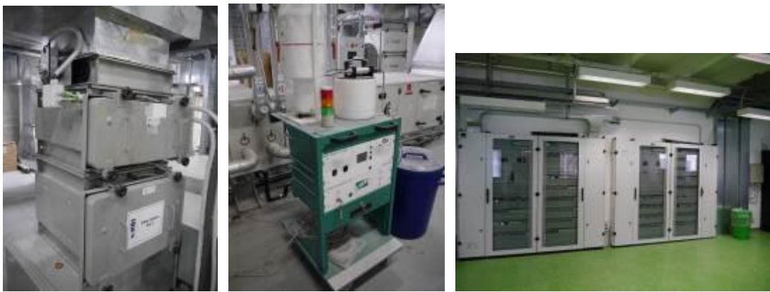
圖九十一、參觀迴旋加速器室上方煙囪排放過濾設備、監測器及控制系統
