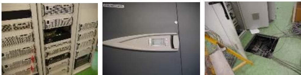
圖八十八、參觀電氣設備室：管路及電線等均位於地面下，並有空調循環
