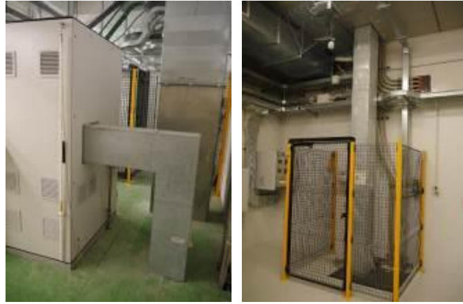
圖九十、參觀電氣設備室：二樓高壓變電設備及鐵網，連接至一樓高壓電及鐵網
