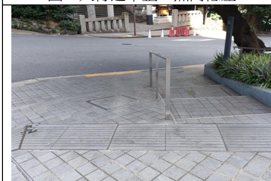
圖 3.人行道與旁邊路面有高低差，設置扶手
