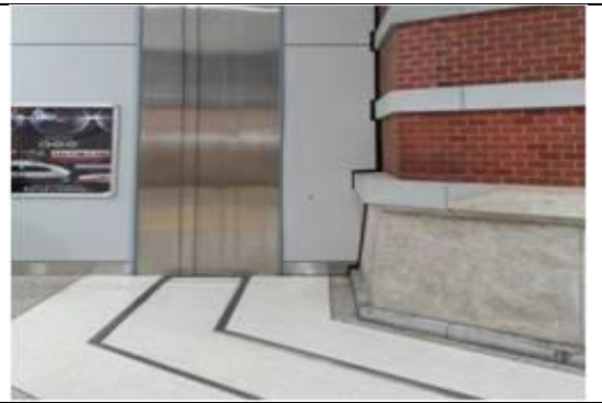
圖 49.東京都丸之內車站隔震設施，產生新舊接合
