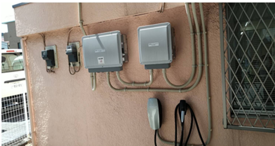
圖 12 聯齊公司設置之儲能/太陽能轉換器等設備
