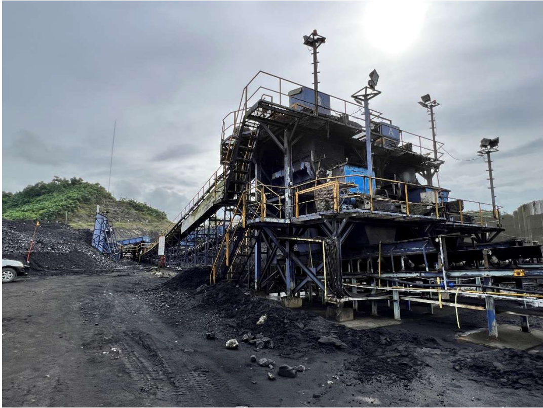
圖 37 Loa Kulu Jetty 之碎煤機
