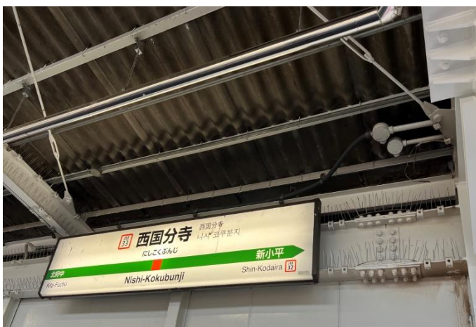
圖 3.6.23 JR 東日本西國分寺站防止鳥類築巢設施(1)
