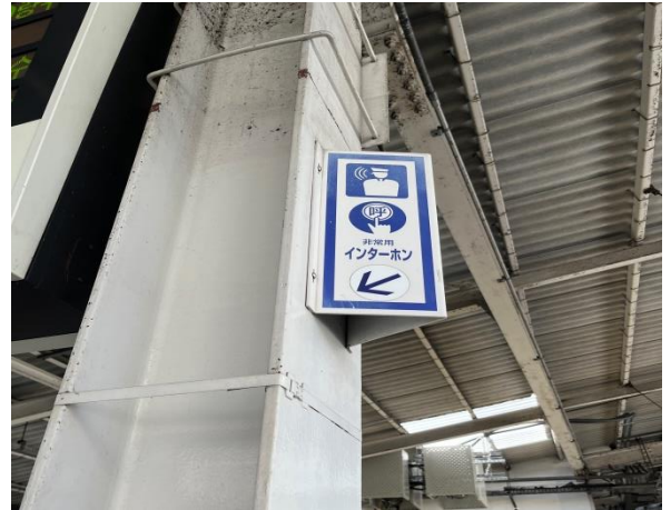
圖 3.6.8 東武鐵道川越站月台上緊急按鈕
