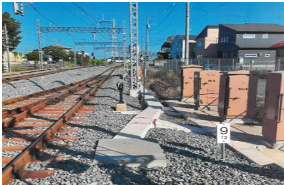
圖 3.2.26 平交道電纜防護
