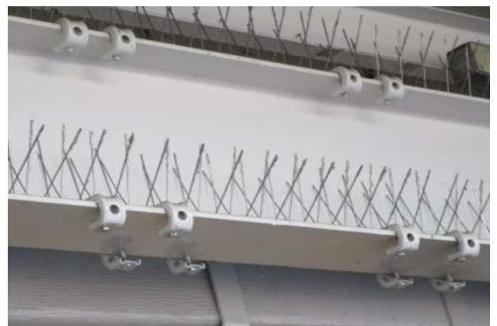
圖 3.6.24 JR 東日本西國分寺站防止鳥類築巢設施(2)
