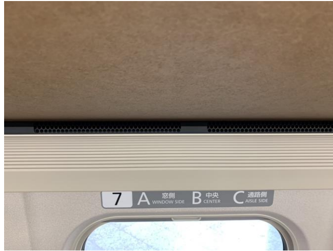
擋板導引冷氣出風口
