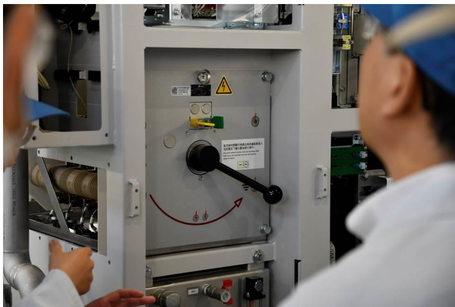
圖 4.6.1-2 電力轉換裝置接地開關與安全連鎖裝置
