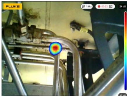
圖 84 聲學成像儀(超音波聲學相機)應用-車輛空氣煞車系統洩漏檢測
