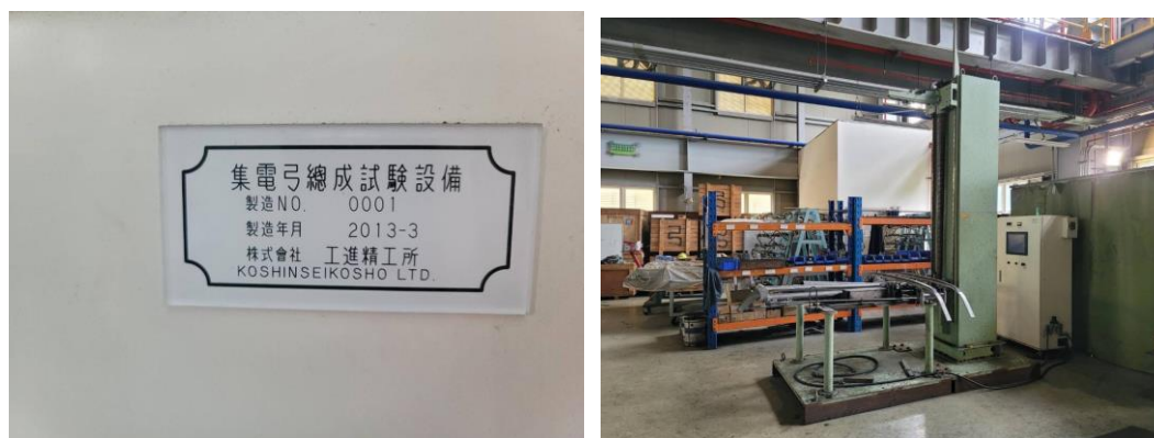
圖 64 富岡基地普悠瑪自強號(TEMU2000 型)KP151 集電弓專用試驗設備
