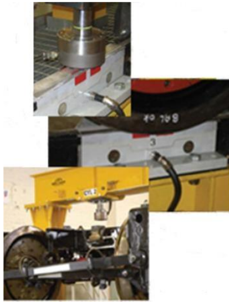
圖 58 軌道車輛維修機廠 荷重元系統
