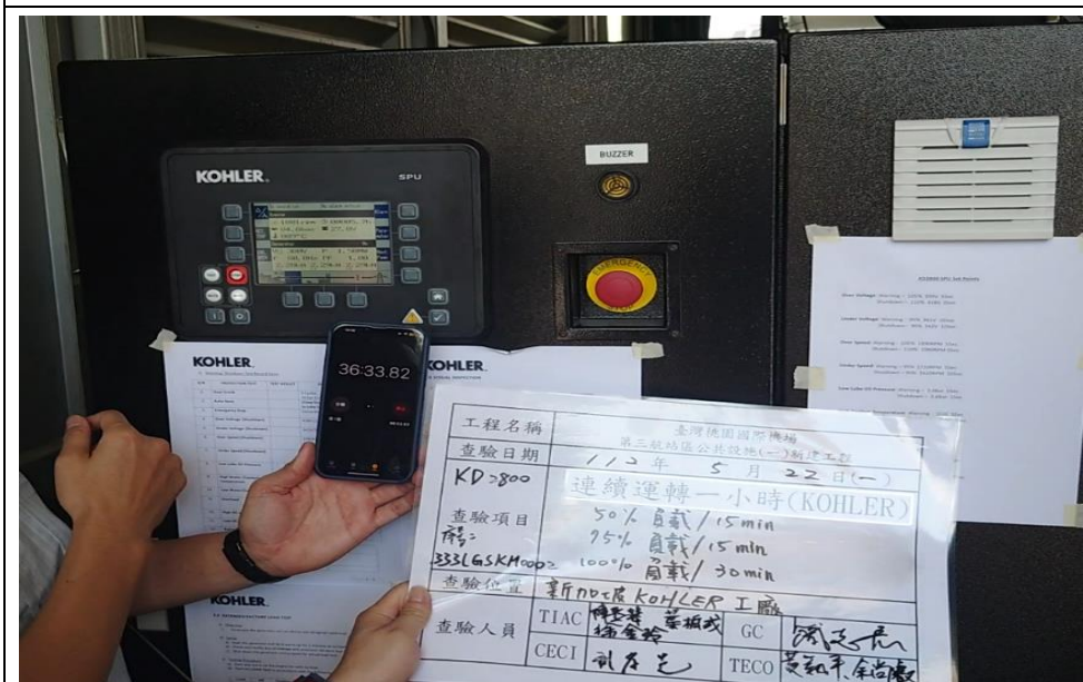
圖 3- 43 柴油發電機負載測試 100% (2000KW) 30 分鐘
