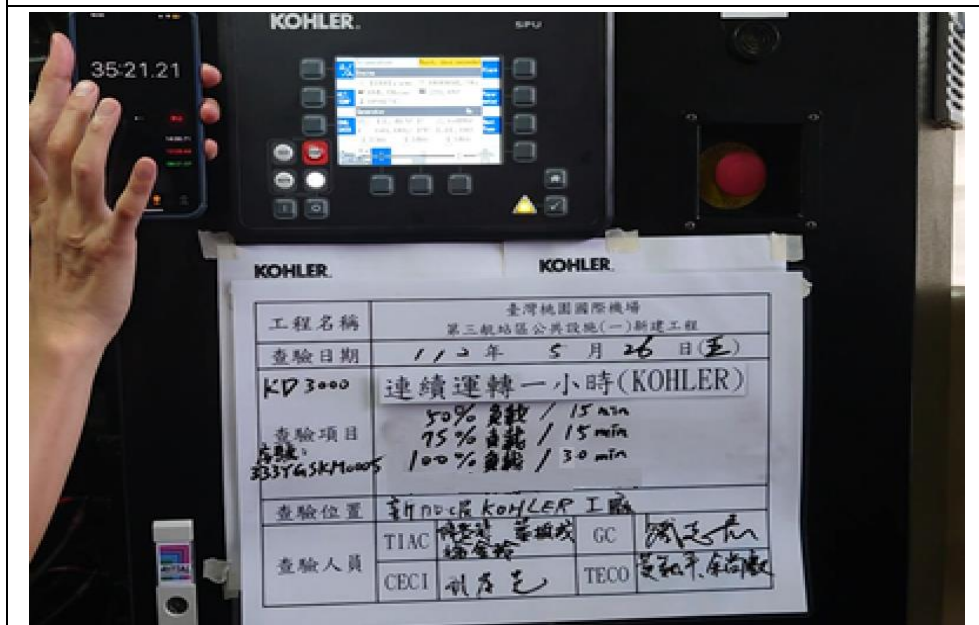
圖 3- 62 柴油發電機負載測試 100% (2700KW) 30 分鐘
