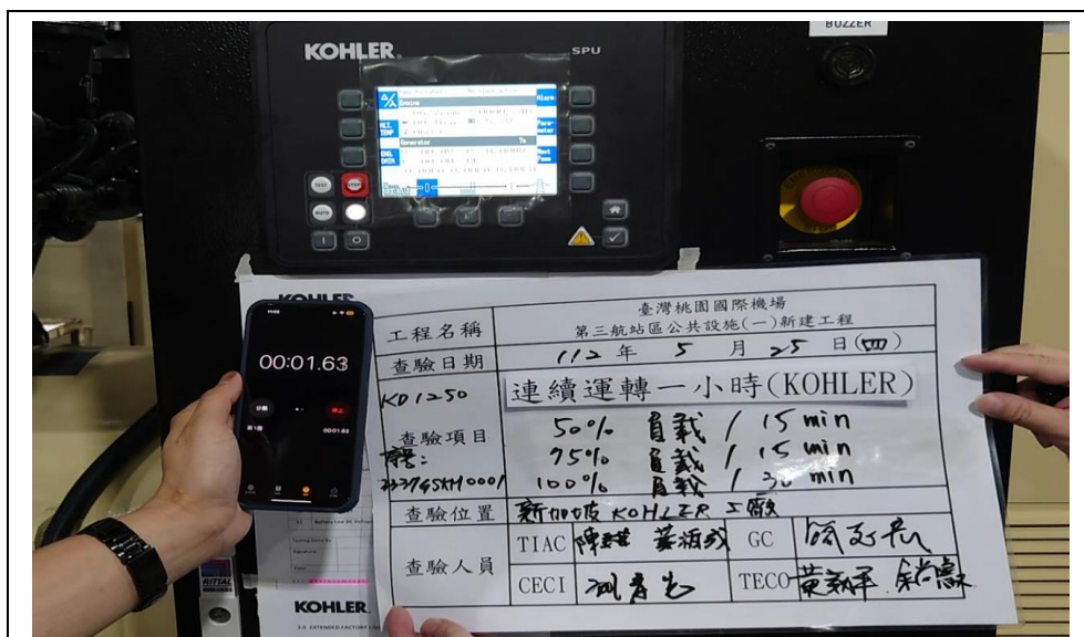
圖 3-21 柴油發電機負載測試 0% (0KW) 5 分鐘
