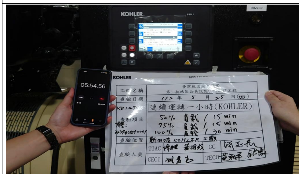
圖 3-22 柴油發電機負載測試 50% (625KW) 15 分鐘
