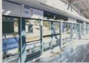
平台屏蔽門 Platform Screen Door (PSD)
