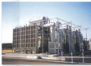
■ 自励変圧器 200kVA 200V/100kV 1φ 50Hz Autotransformer for substation
