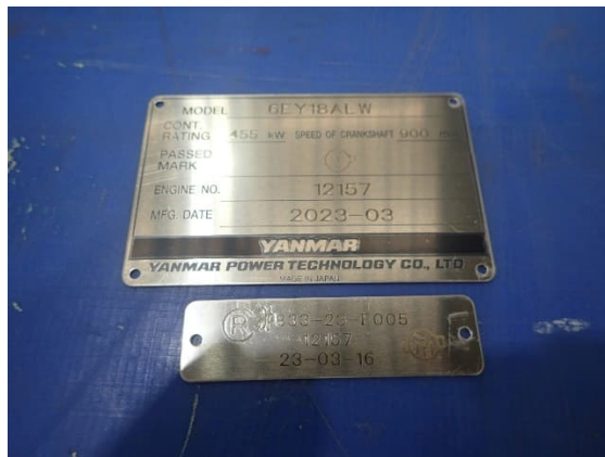
1 號發電機之銘牌及鋼印
