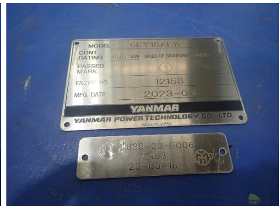
2 號發電機之銘牌及鋼印
