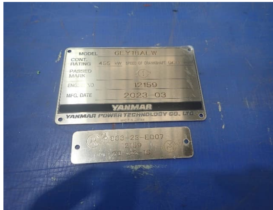
3 號發電機之銘牌及鋼印
