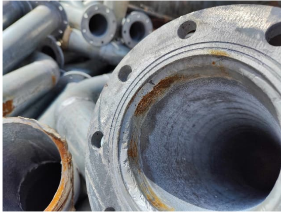
鍍鋅管焊道附近生鏽管路
