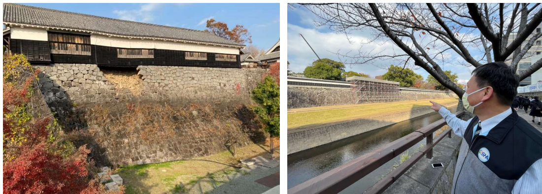
圖 9. 熊本城天守閣之城牆損壞情形
