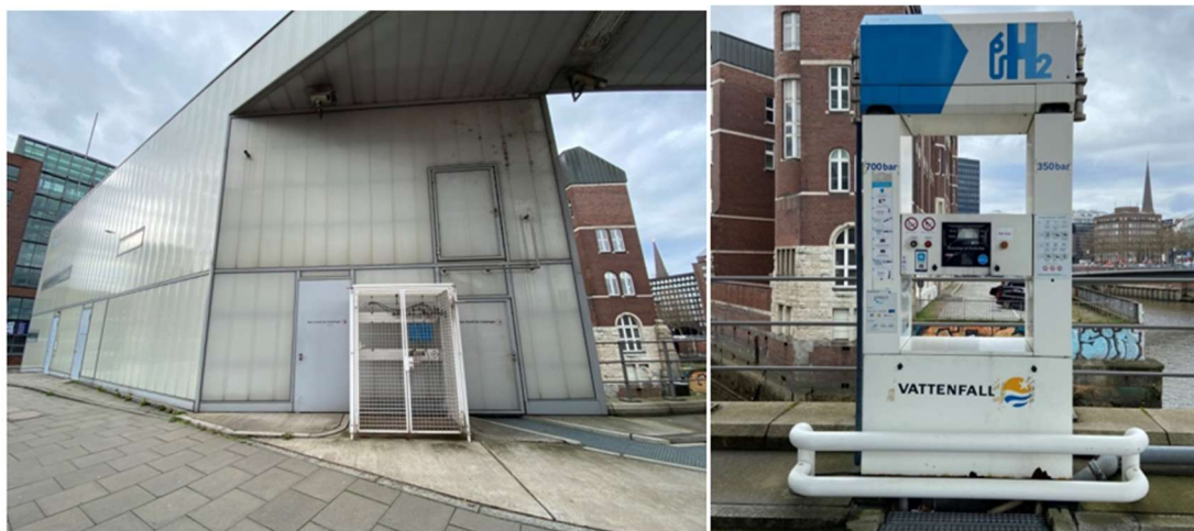
圖 26 (左) 德國漢堡設置之加氫站儲氫區 (右)加氫機
