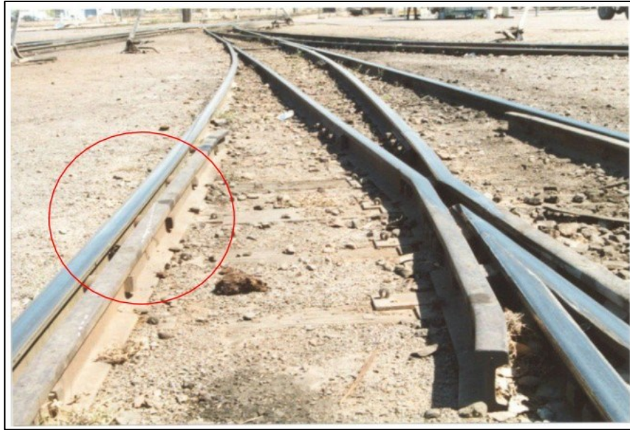
圖 9 磨損岔心旁之護軌出軌痕跡
