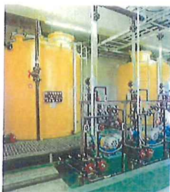
塩素注入設備
