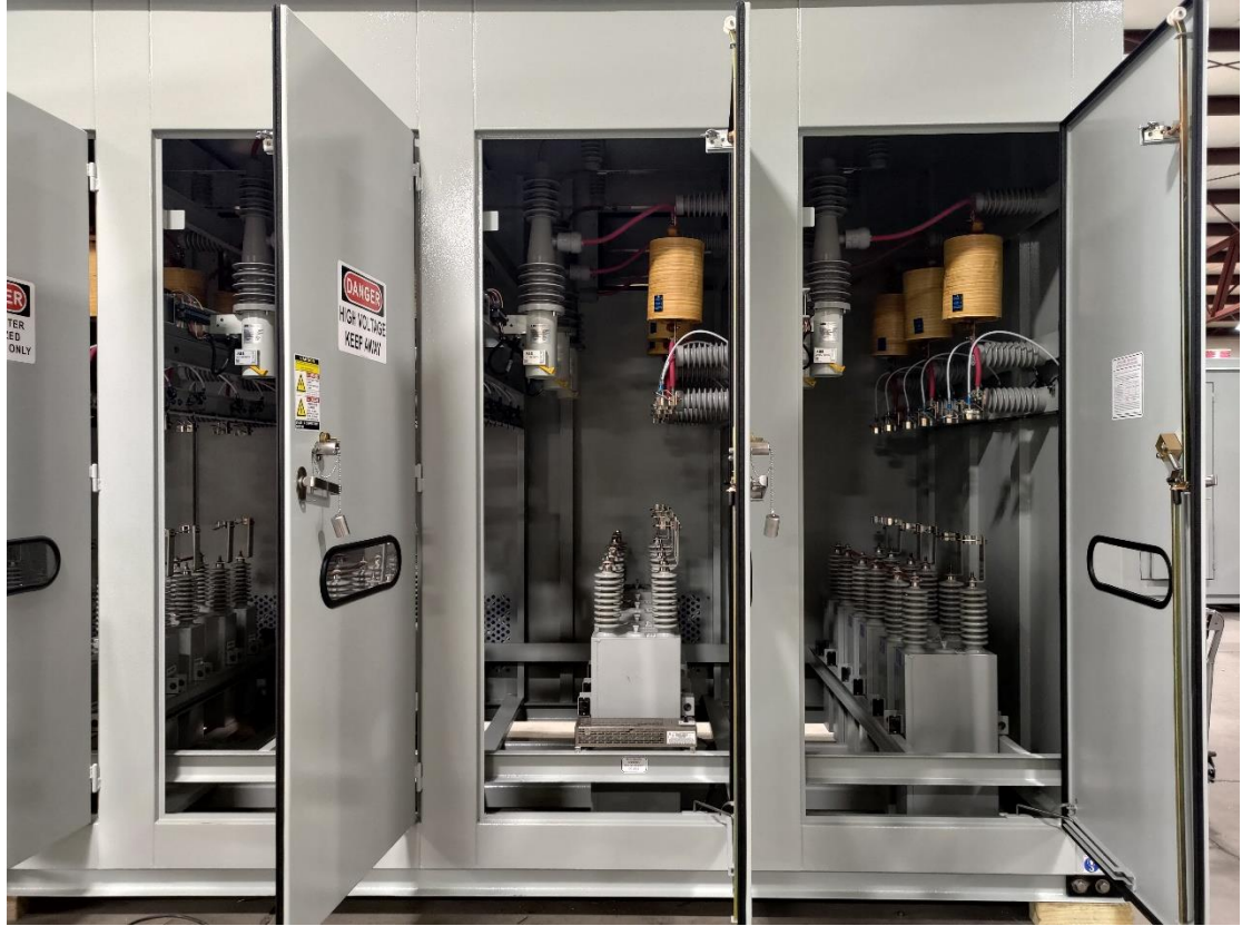
圖46 諧波濾波器設備
