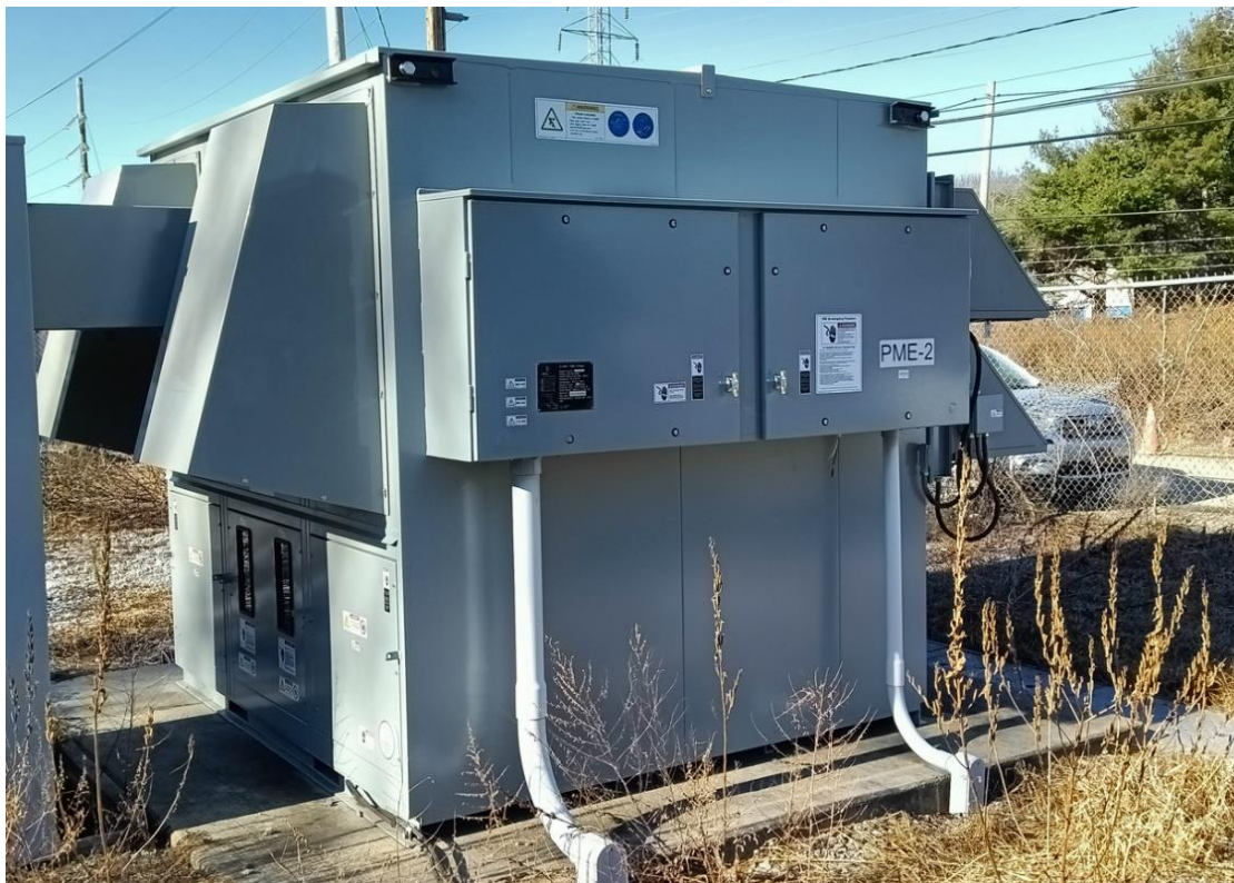
圖14 LIPA 於長島之變電站建置 D-VAR STATCOM
