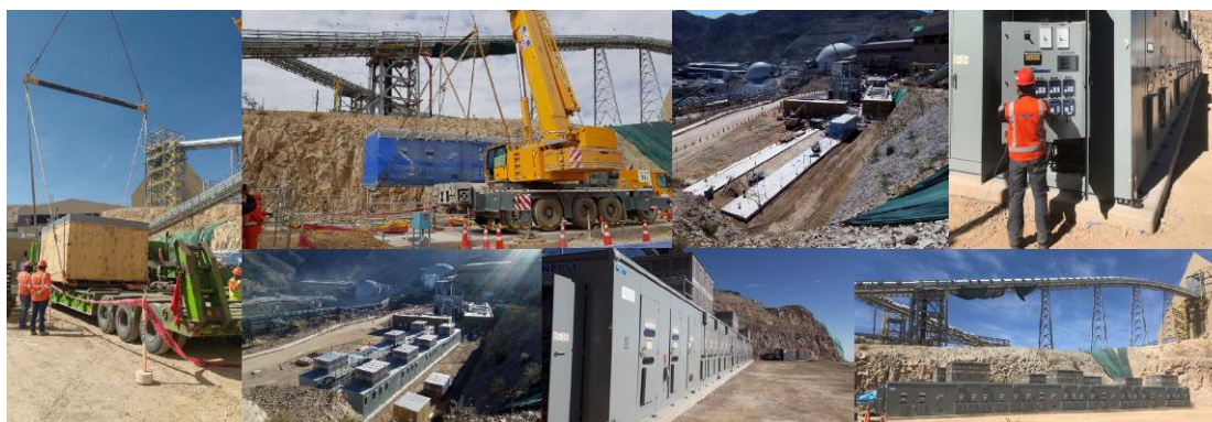
圖41 Toquepala Mine 濾波器裝置照片
