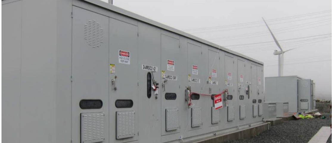
圖43 Cape Scott 方廠裝設之大型電容器
