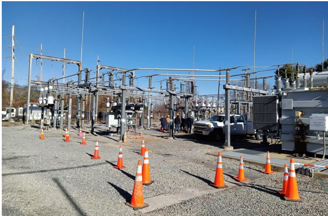
圖13 LIPA 於長島之變電站
