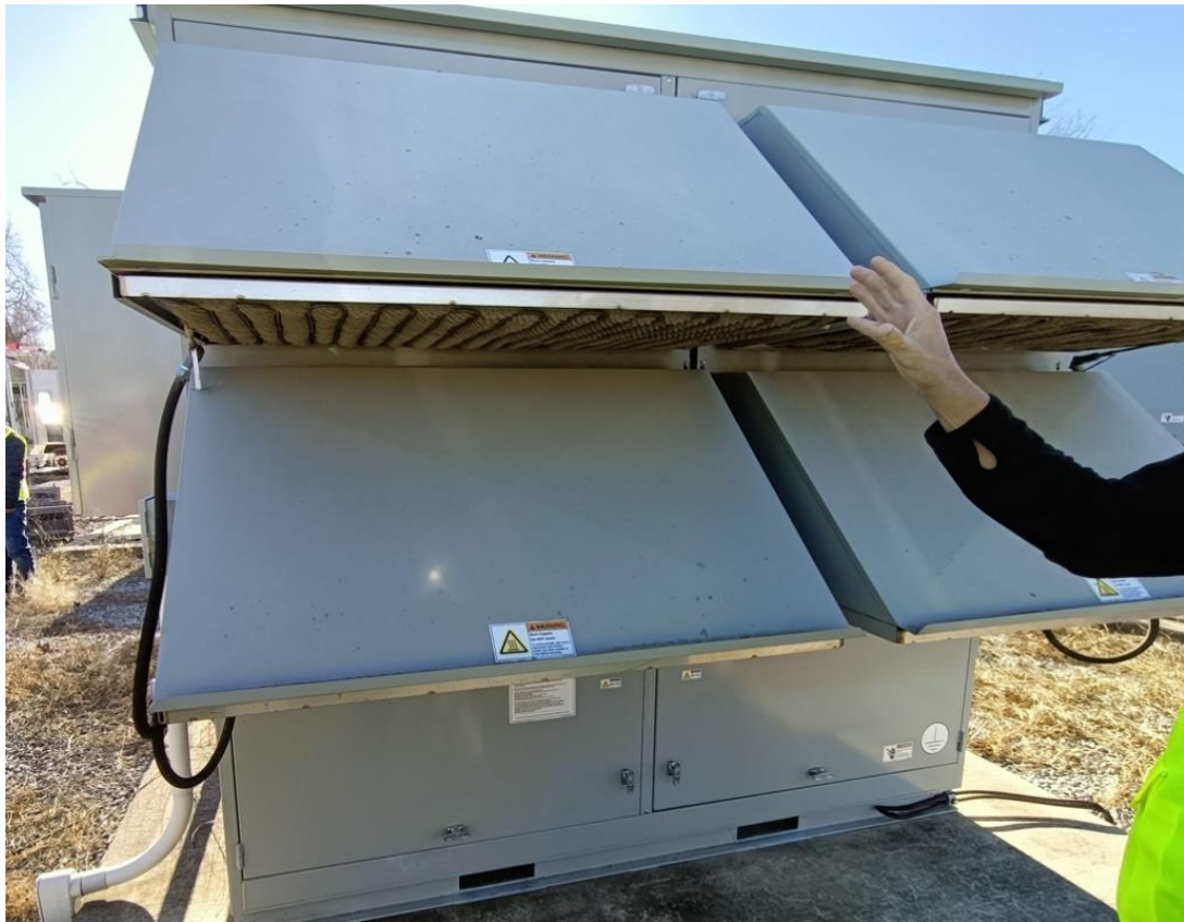
圖15 LIPA 於長島之變電站建置 D-VAR STATCOM
