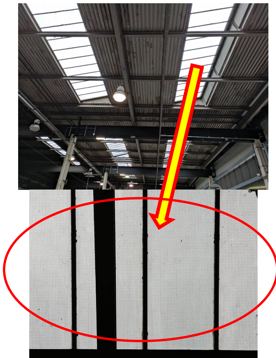
圖 10 屋頂採光板設置堅固格柵防止墜落風險
