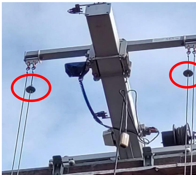
圖 9 捲揚機均有設置過捲揚預防裝置
