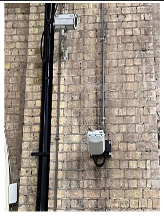
圖 3.4.20 監視系統防禽類築巢措施
