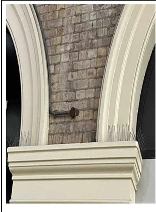
圖 3.4.19 建物防禽類築巢措施
