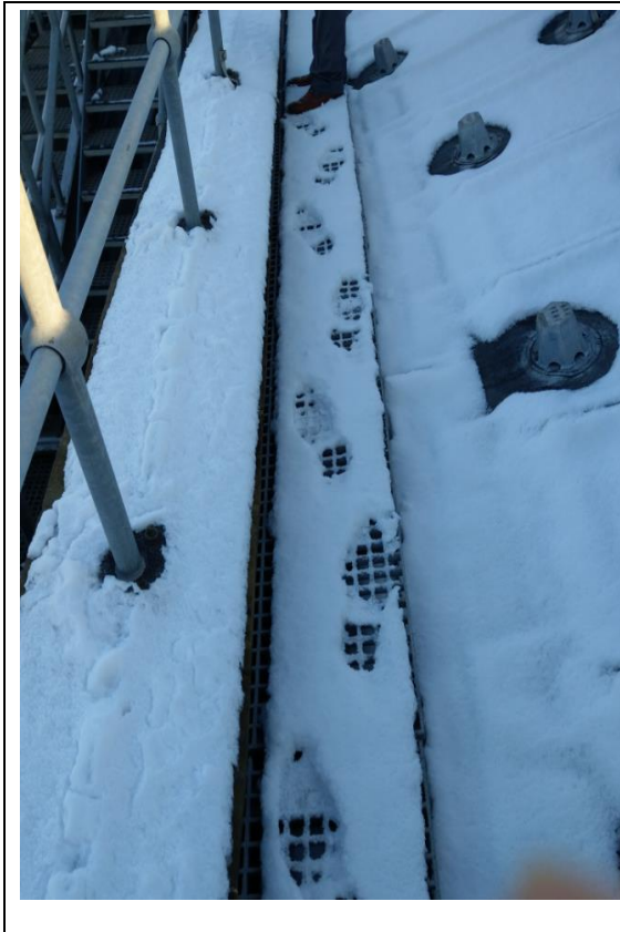
圖 3.4.9 屋頂作業之固定式安全通道(一)
