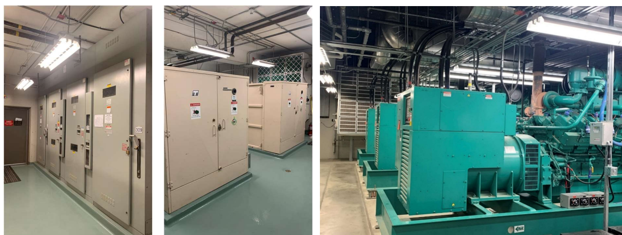
圖三、電力系統與緊急發電機組(摘錄自課程講義)
