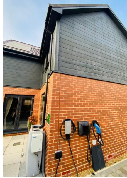
圖 33 Z House 外部電力設備
