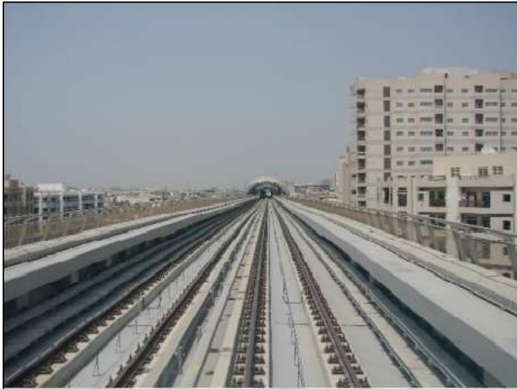
圖 59 軌道缺陷調查_直線段
