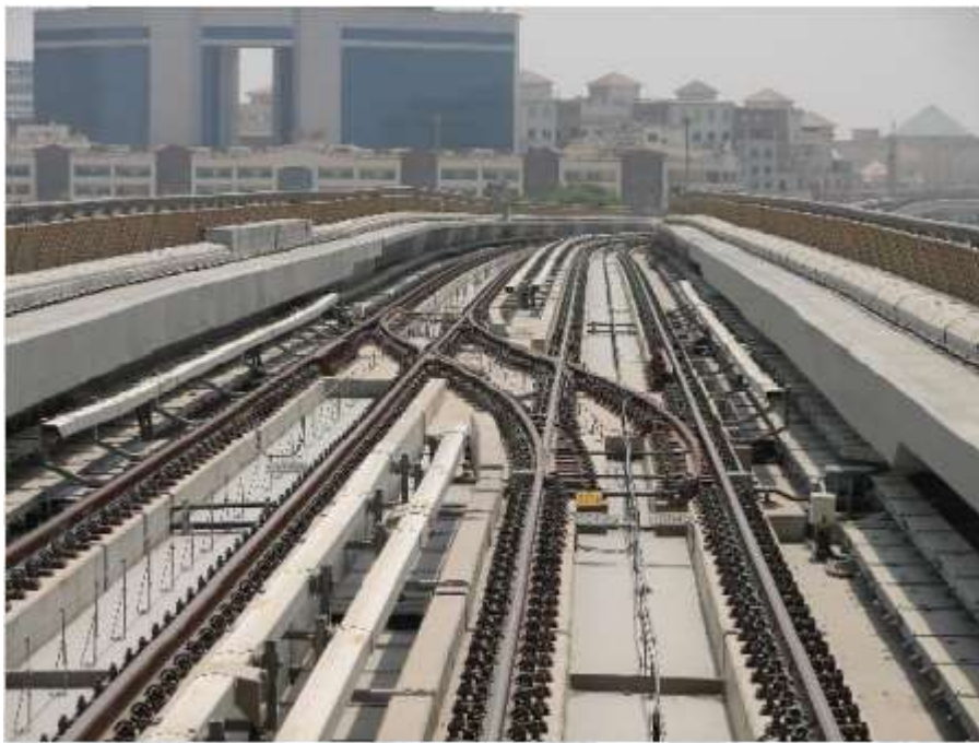
圖 60 軌道缺陷調查_道岔段
