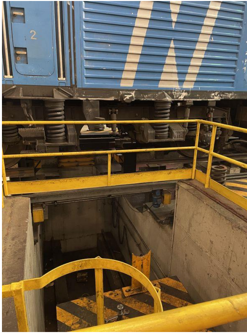
可單獨拆裝車輪之維修坑
