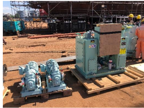
到廠設備(待安裝)
