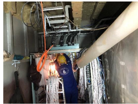
舵機控制盤接線
