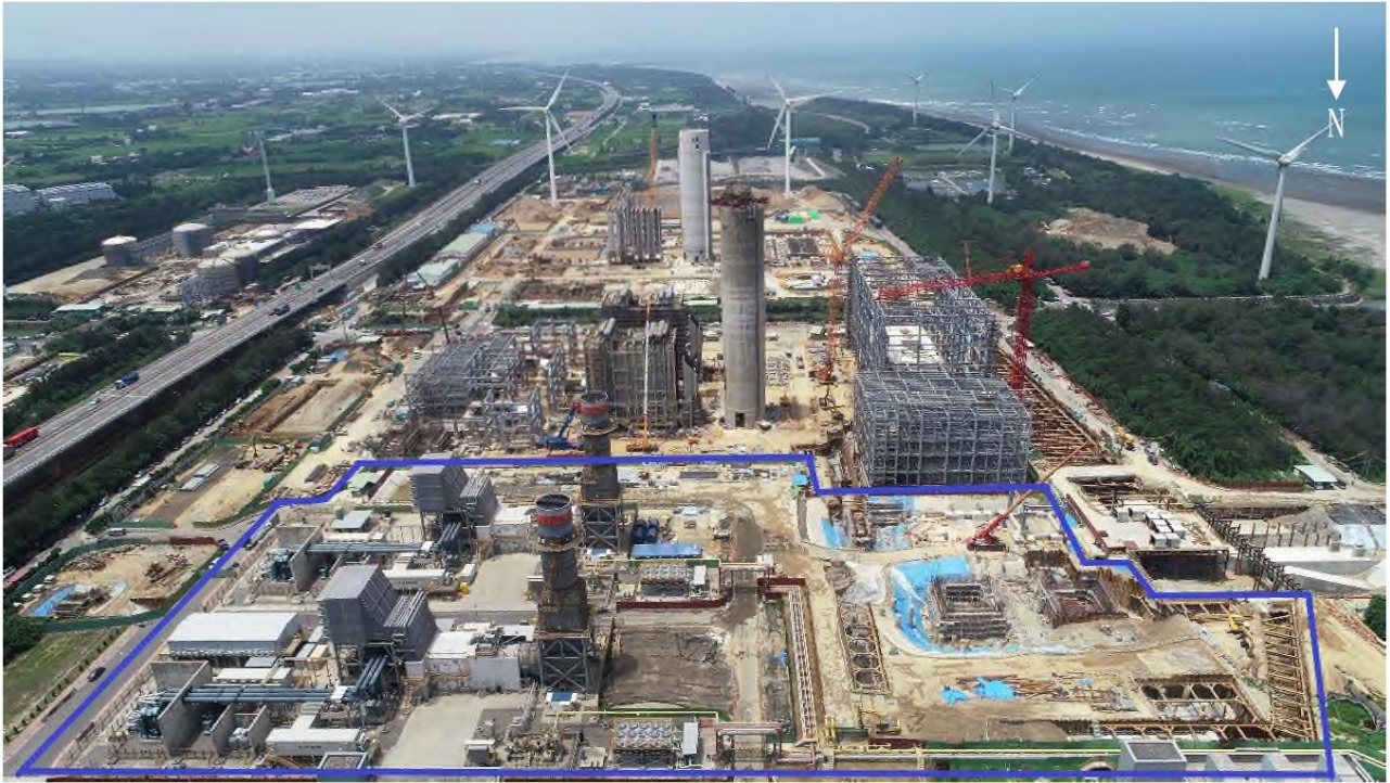
圖 18 7 號機單循環擴建複循環機組-側面
