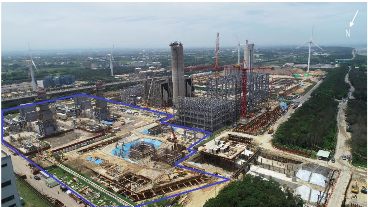
圖 19 7 號機單循環擴建複循環機組-斜後方
