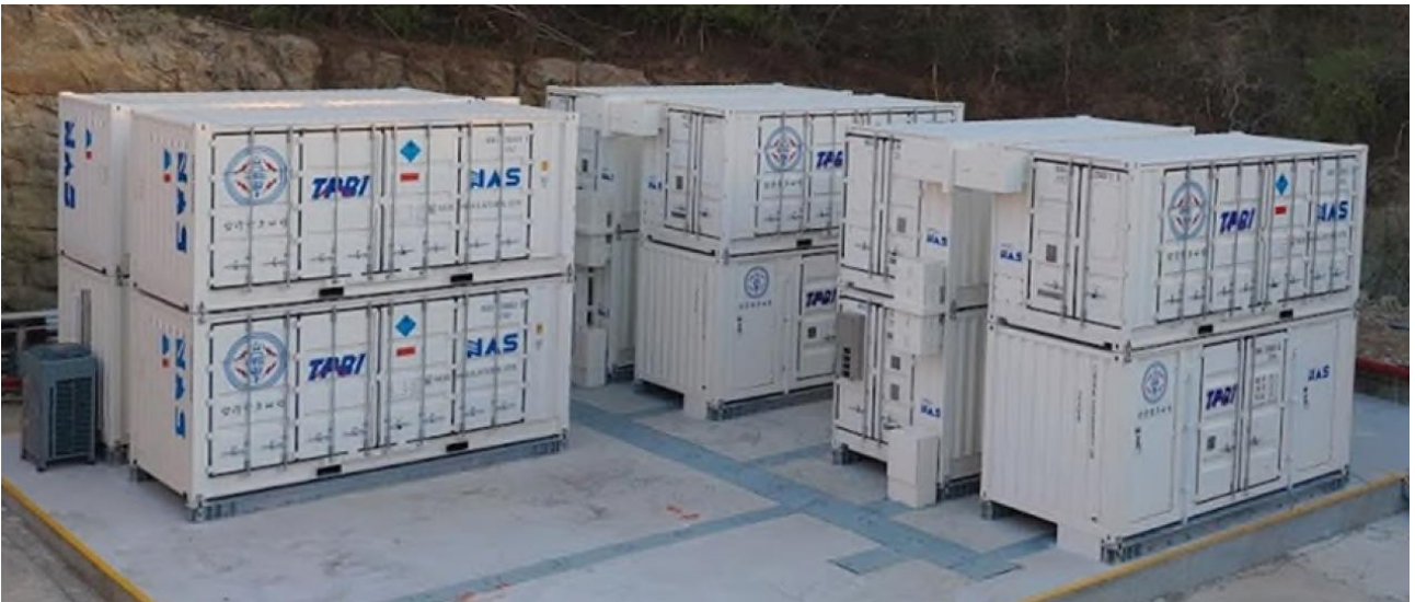
圖 6 儲能一期(1.8MW/10.8MWh 能量型儲能)
