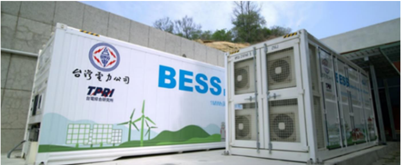
圖 8 儲能二期(2MW/1MWh 功率型儲能)
