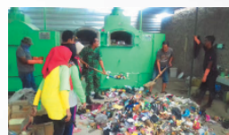
Mini Incinerator for Rural Area
